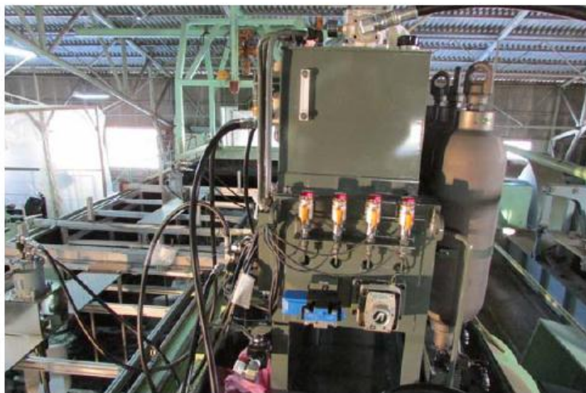
油圧システム (オイルタンク、蓄圧器)
