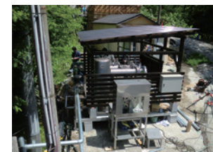
■大崎市鳴子温泉中山平地区において行われているバイナリー発電システムの実証試験の様子
